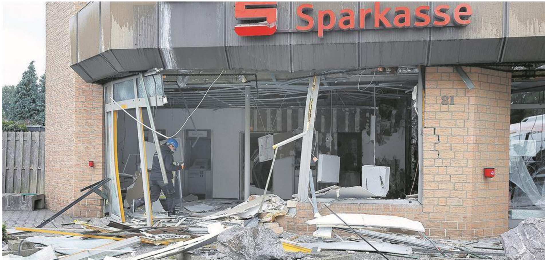
Die Sparkassen-Filiale an der Rünther Straße ist nur noch ein Trümmerhaufen. Alle Räume im Erdgeschoss sind verwüstet.
